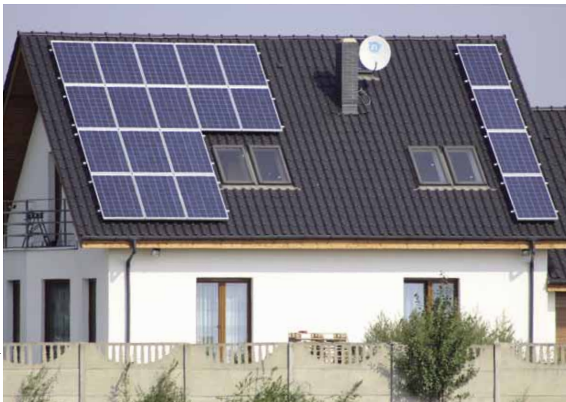
Przykład prosumenckiej instalacji fotowoltaicznej na dachu domku jednorodzinnego
