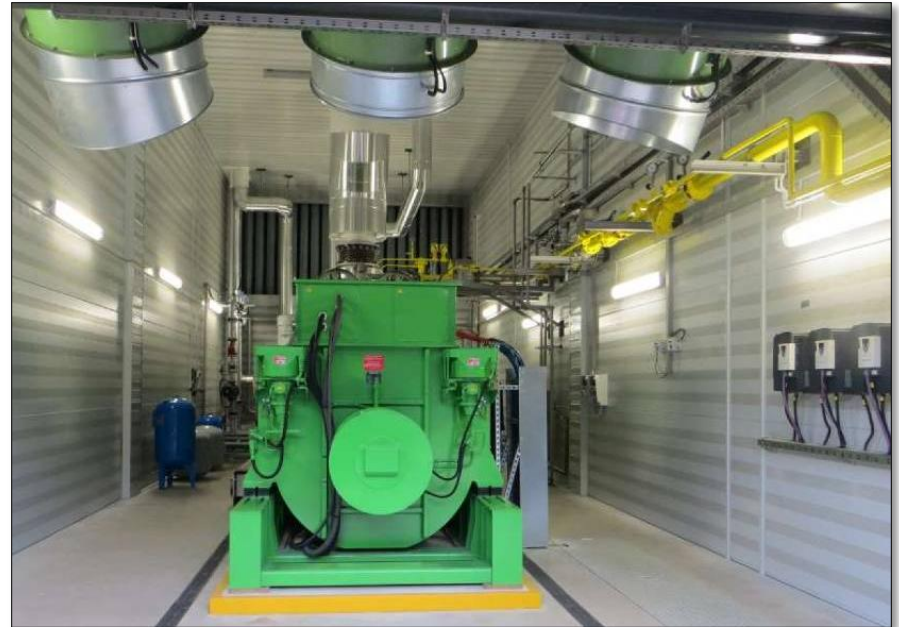
Przykład: Uruchomienie przez MEC Piła jednego z najnowocześniejszych źródeł ciepła w kraju: kogeneracyjna elektrociepłownia produkująca równocześnie ciepło i prąd
